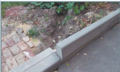
После дождя жители затопленного подвезда сами организовали водоотвод.
