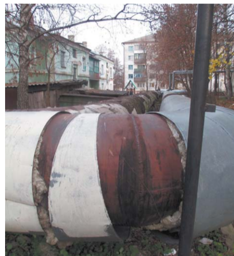
Трубы на перекрёстке улиц Сурина Шаумяна и Красноармейской подлатали только со стороны проезжей части, с другой стороны остались «пропешины»
