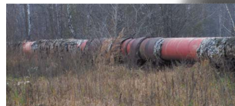
Труба со сползающими остатками изоляции тянется не один километр
