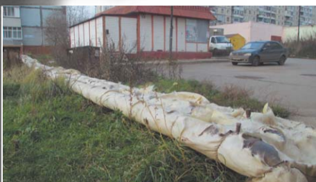
Изоляция на трубах между домами на улице Раздольной вся изорвана
