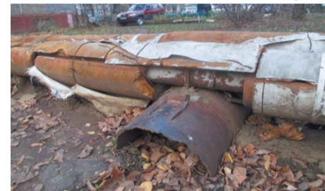
На улице Бурова трубы тоже греют воздух
