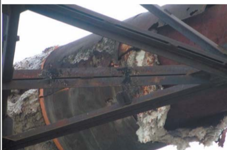
Много лет никто не обновлял изоляцию
