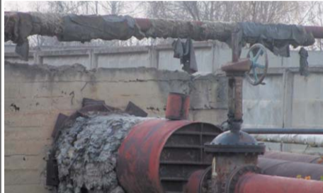
На трубах в районе сталепрокатного завода изоляция сохранилась лишь местами
