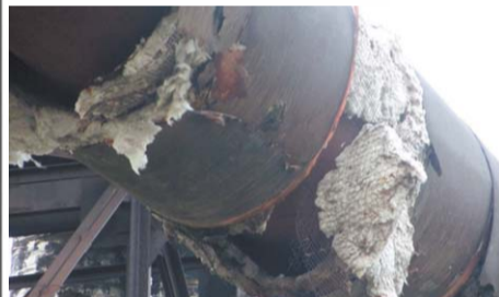
Истлевшее железо и утеплитель отваливаются и падают на землю
